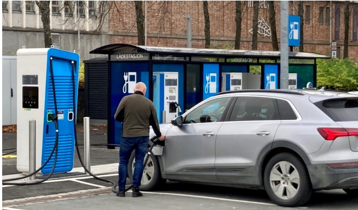
Installations de chargement dans Trondheim, Norvège
